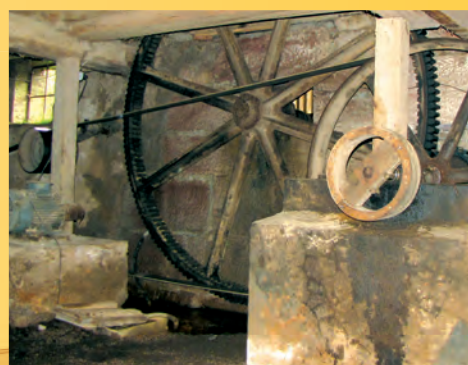
▲ Sous-sol : transmission ; au premier plan, la poulie d'entraînement du trieur à grain, à gauche le moteur électrique
